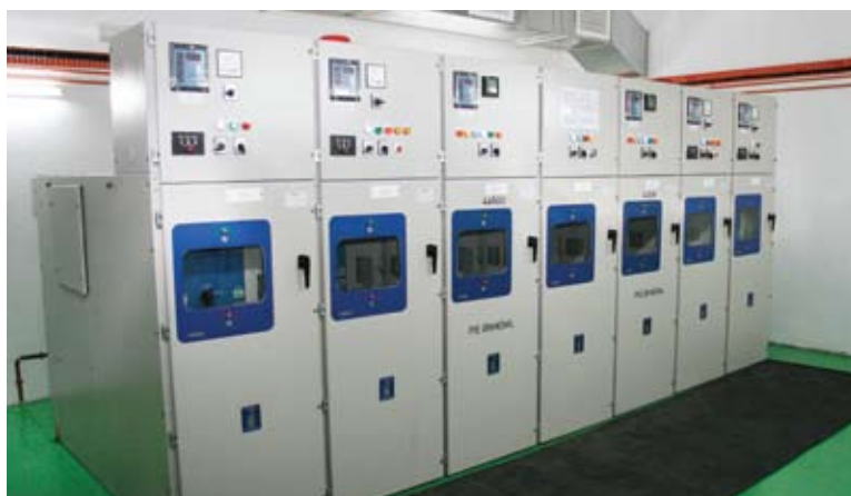
Strateq 开关切换室的电力升级改造
